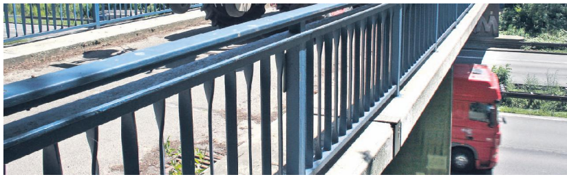
Der Wirtschaftsweg über die Autobahn ist eine wichtige Verbindung für Radfahrer und Spaziergänger und knüpft an das Radwegenetz des Kreises Unna an. Sie soll für die Verbreiterung der Autobahn abgerissen werden. Politik und Verwaltung fordern einen Ersatz für Fußgänger und Radfahrer. Der landwirtschaftliche Verkehr wird dann über die Vincenz-Wiederholt-Straße geschickt. Foto: Hennes
